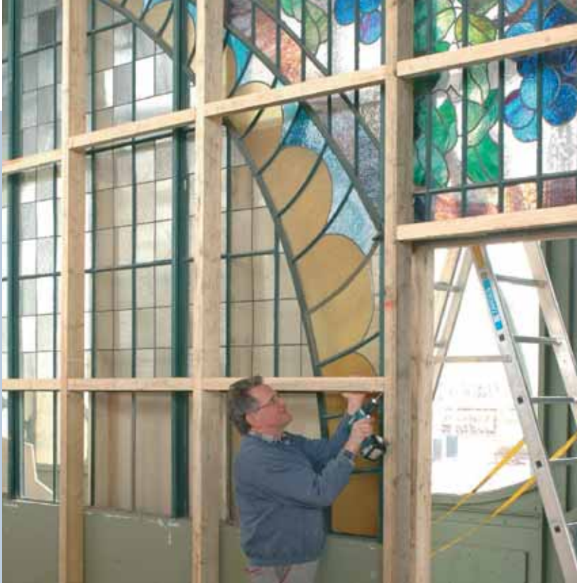
Ludger Becker vom LWL-Industriemuseum arbeitet an der Holzverkleidung, die das Jugendstil-Portal der Maschinenhalle während der Sanierungsarbeiten schützen wird
