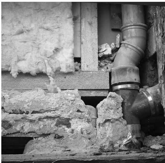
2 Langzeitschaden einer von innen gedämmter und mit ungeeignetem Anstrich behandelten historischen Fachwerkwand.
