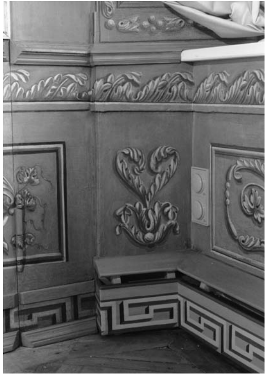
12 Schloss Burgsteinfurt, „Blauer Saal“, Südwestecke, Sockelbereich nach der Restaurierung mit neu installierten Steckdosen und Heizungssystem. 2004.
