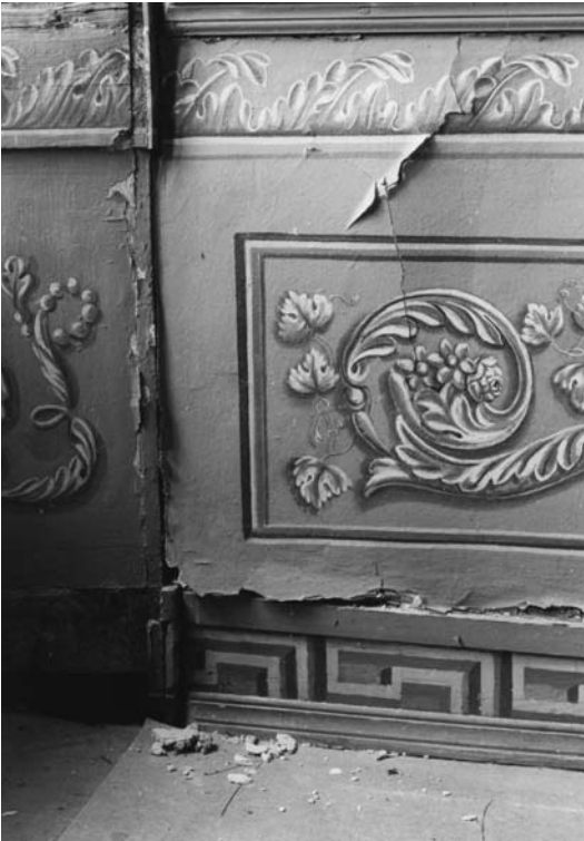
11 Schloss Burgsteinfurt, „Blauer Saal“, Südostecke, Sockelbereich, Schadensbild am Übergang von der Holzvertäfelten zur geputzten Wand. 2004.
