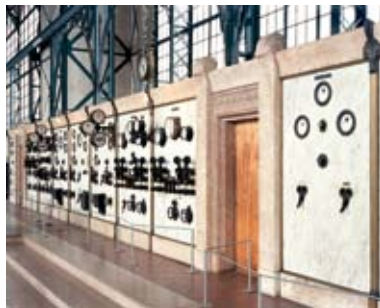
Schalttafel (links) und Portal (rechts) der Maschinenhalle.
